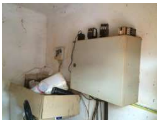
Quadro de comando
