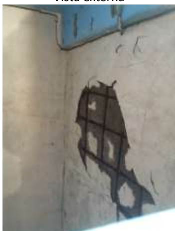
Necessidade de pequenos reparos
