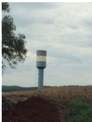
Figura 53 - Reservatório poços 13 e 14. Fonte: CEPMSB, 2015.
