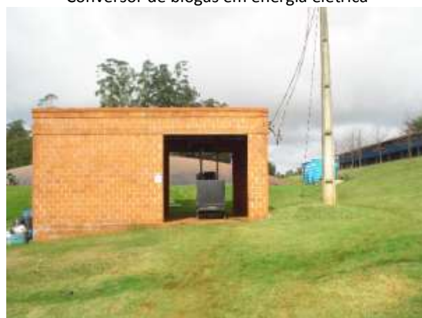
Conversor de biogás em energia elétrica
