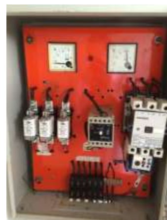
Quadro de comando – vista interna
