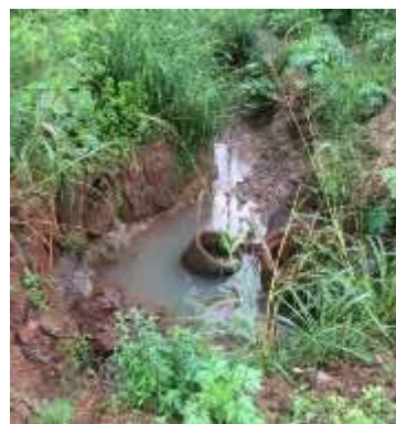
Saídas de drenagem com erosão
