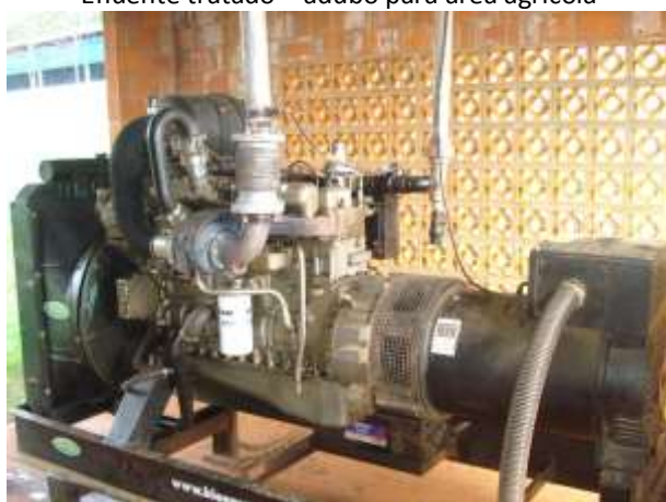
Conversor de biogás em energia elétrica
