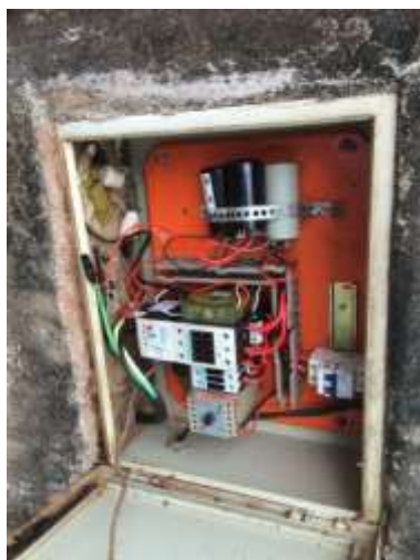
Quadro de comando
