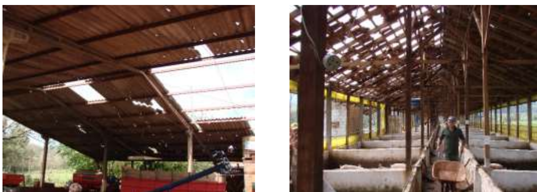
Figura 83 - Estragos provocados por chuva com granizo em Entre Rios do Oeste.
