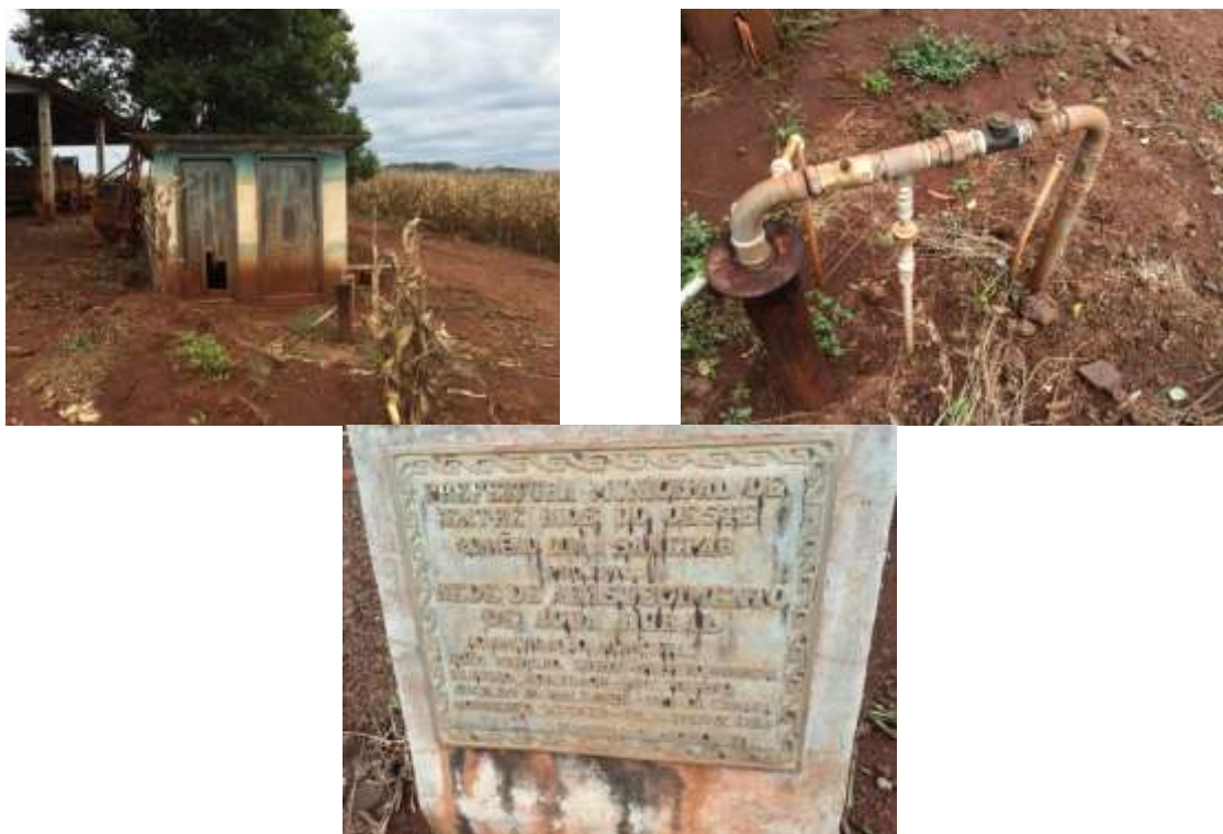
Figura 51 - Poço 13. Fonte: CEPMSB, 2015.
