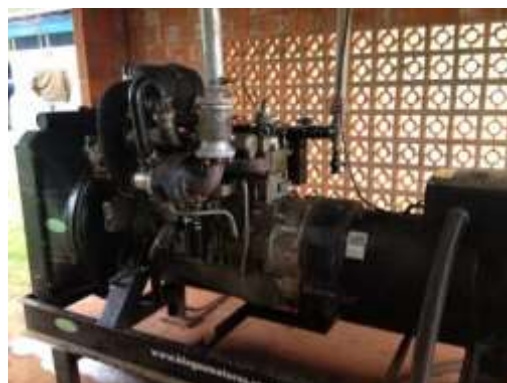
Motor a biogás
