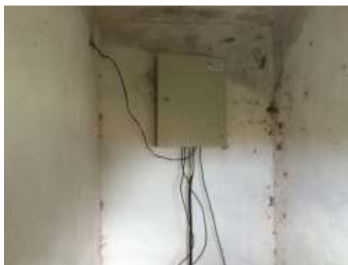
Quadro de comando
