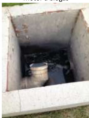
Efluente do Biodigestor para a Lagoa
