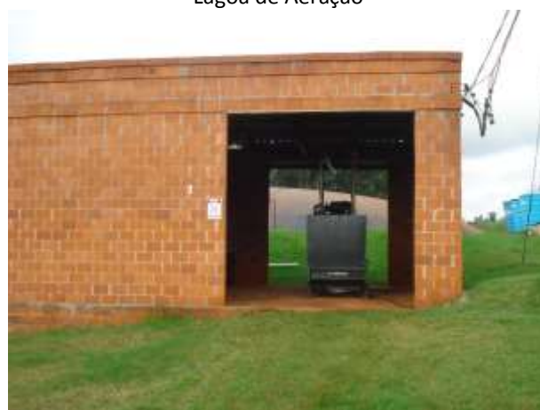
Conversor de biogás em energia elétrica
