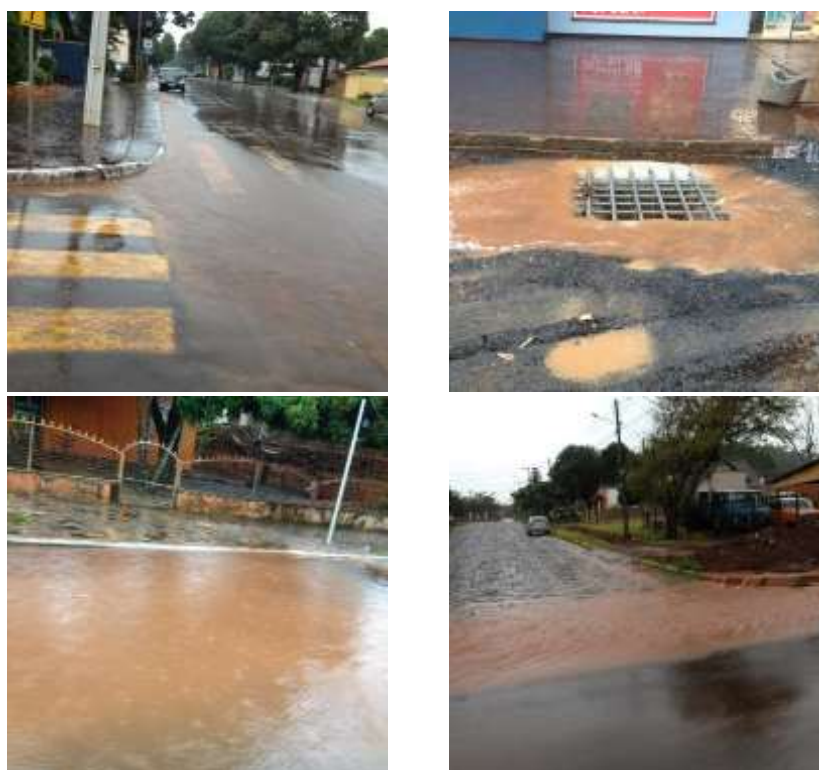
Figura 75 - Sarjetas com água acumulada em tempo chuvoso na PR-495 próximo à Prefeitura.
