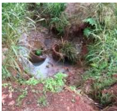
Saídas de drenagem com erosão
