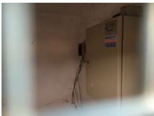
Quadro de comando – vista externa
