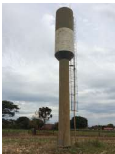
Figura 35 - Reservatório poços 20, 21 e 10(desativado). Fonte: CEPMSB, 2015.
