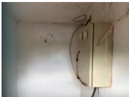
Quadro de comando
